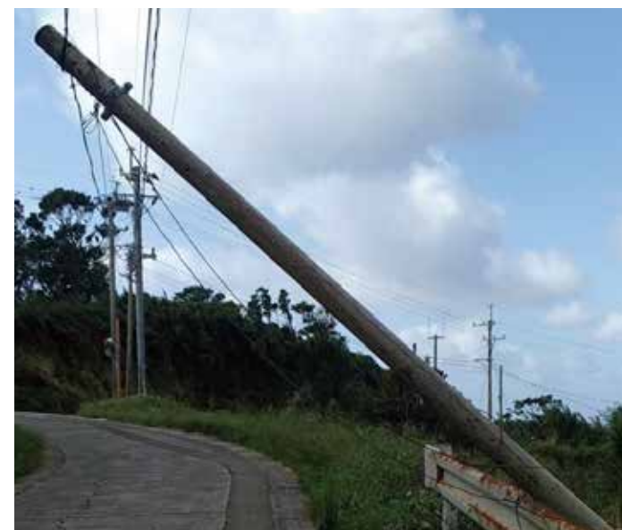
▼島内の被害も一部出ています（悪石島）
