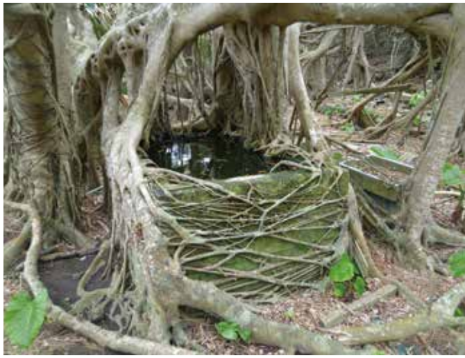
コンクリート製の水桧は、ガジュマルの根に取り囲まれた
