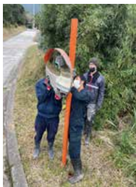
←カーブミラーの設置
